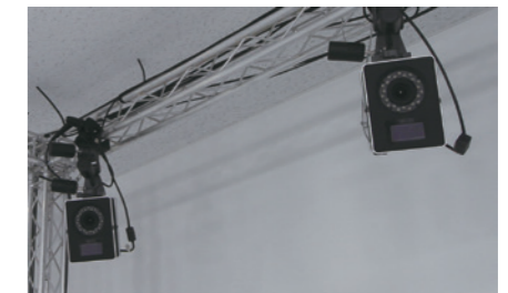
32台のカメラが設置されている
